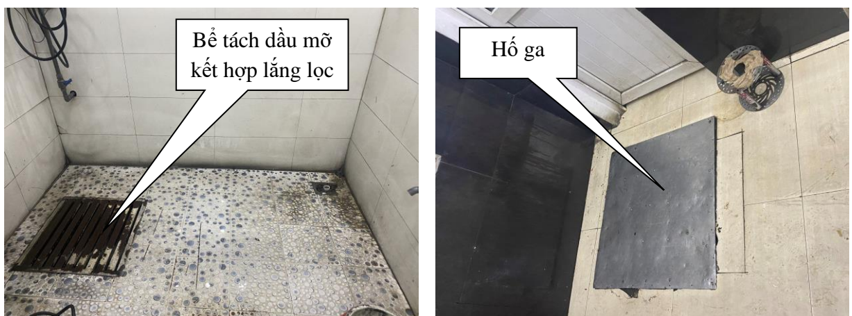
Hình 3.4. Công trình xử lý nước thải tại Cơ sở
