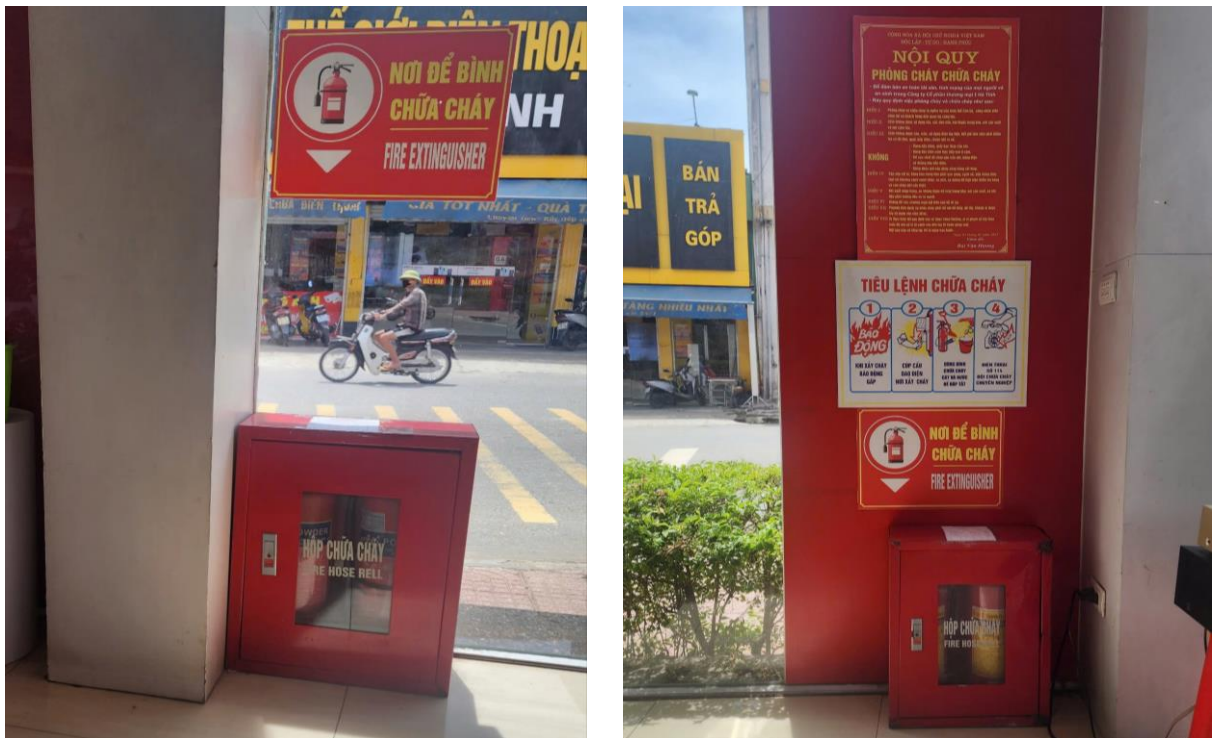
Hình 3.8. Các công trình PCCC tại Cơ sở
