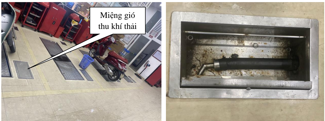
Hình 3.5. Công trình thu gom khí thải từ hoạt động sửa chữa xe máy
